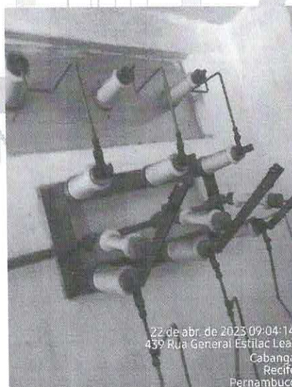
Foto 05 – Chave Seccionadora MT – Excesso de poeira e falta de lubrificação
