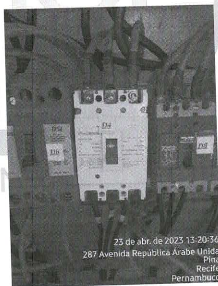
Foto 20 – Disjuntor de BT – Disjuntor de 100A substituído
