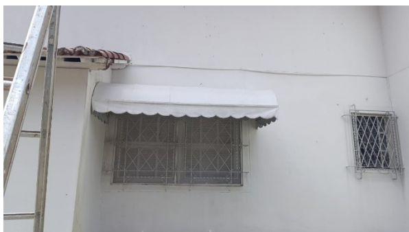
Fig. 2) Necessidade de 03 (três) toldos , conforme abaixo:
