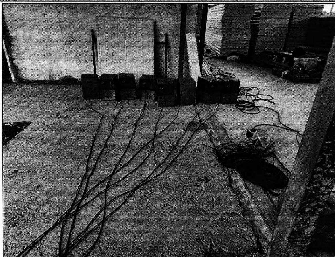
Descrição: cabos lógica
