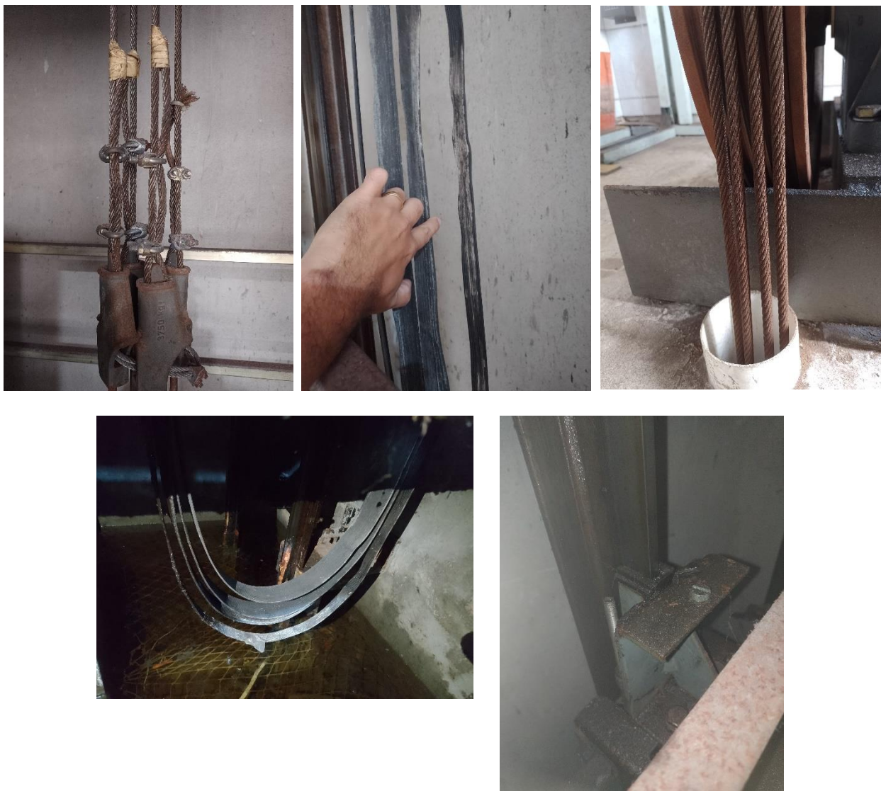
Figuras 3 – Cabos de aço, Cabos de manobra e Guias do Carro (Trilhos)
