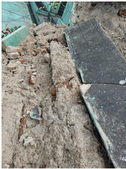
Muro de Arrimo Tombado - 22/07/2024
