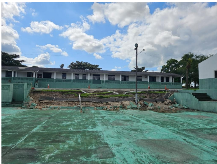
Região Afetada do Muro de Arrimo - 22/07/2024
