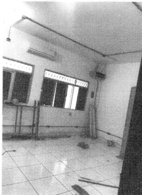
Foto 5 – Imagem da Sala de Informática (Sala dos nobres) projeto elétrico com ausência de DPS.
