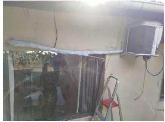
2-HT REFEITÓRIO CONSUL 18K CONVENCIONAL CABO TOTALMENTE OXIDADO FEITA A SUBSTITUIÇÃO DO CABO PP 5M. 24/09/2025 20:20
