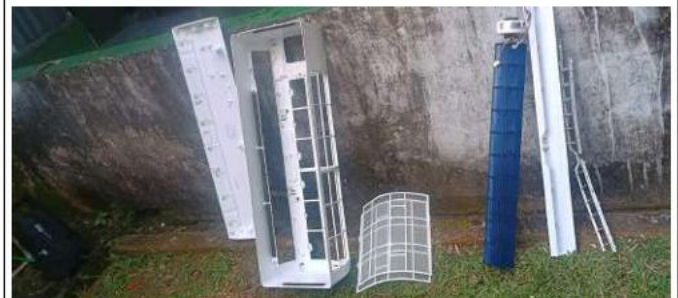
13-HT RECEPÇÃO MANUTENÇÃO DEPOIS 24/09/2025 20:25
