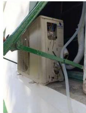
4-Quartel oficial de dia Komeco 12.000 Btus Reinstalação e 25/09/2025 16:07
