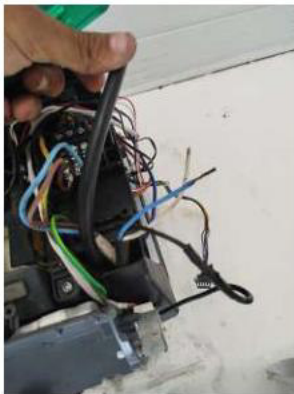
3-HT REFEITÓRIO CONSUL 18K CONVENCIONAL CABO TOTALMENTE OXIDADO FEITA A SUBSTITUIÇÃO DO CABO PP 5M. 24/09/2025 20:21
