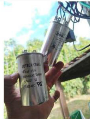
4-HT REFEITÓRIO CONSUL 18K CONVENCIONAL CAPACITOR ESTOURADO E CAPACITÂNCIA ACIMA DO RECOMENDADO, FEITA A SUBSTITUIÇÃO OK 35UF. 24/09/2025 20:21
