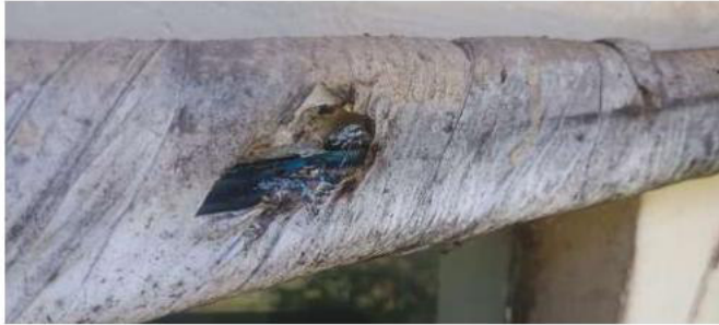
1-HT REFEITÓRIO CONSUL 18K CONVENCIONAL CABO TOTALMENTE OXIDADO 24/09/2025 20:19
