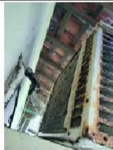
4-HT - Quarto 01 York 12K Baixo rendimento desinstalação 09° 38' 7.6" S 35° 44' 6.0" W - 10/09/2025 14:23
