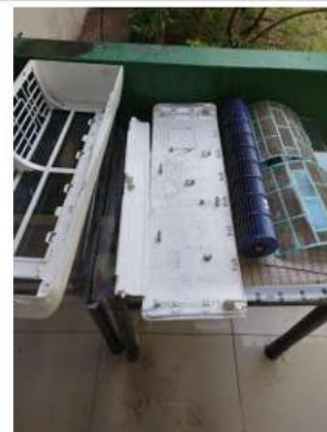
11-HT REFEITÓRIO ELGIN INVERTER MANUTENÇÃO ANTES 24/09/2025 20:25
