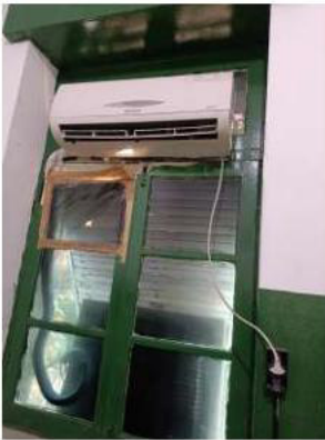
5-Quartel oficial de dia Komeco 12.000 Btus Reinstalação e 25/09/2025 16:07
