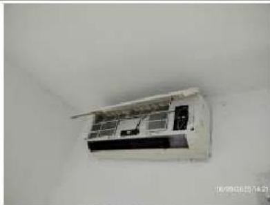
1-HT - Quarto 01 York 12K Baixo rendimento desinstalação 09° 38' 28.0" S 35° 44' 8.0" W - 10/09/2025 14:21
