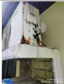
3-HT - Quarto 01 York 12K Baixo rendimento desinstalação 09° 38' 7.6" S 35° 44' 6.0" W - 10/09/2025 14:23
