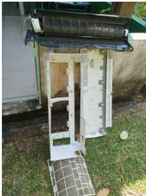
5-HT REFEITÓRIO CONSUL 18K CONVENCIONAL MANUTENÇÃO ANTES 24/09/2025 20:22
