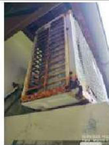
2-HT - Quarto 01 York 12K Baixo rendimento desinstalação 09° 38' 8.7" S 35° 44' 6.0" W - 10/09/2025 14:22
